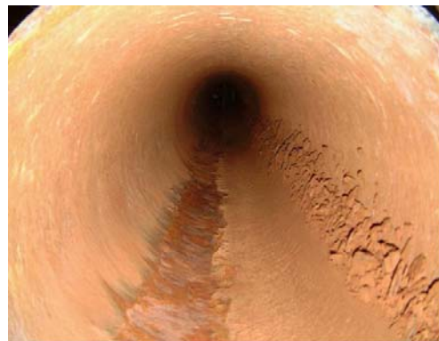
شکل ۶- خوردگی در لوله آب آتش‌نشانی (قسمت درونی)
