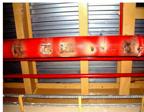
شکل ۷- خوردگی لوله آب آتش‌نشانی و محل‌های جوش
