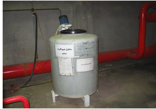
شکل ۹- سیستم تزریق هیپو کلرید سدیم
