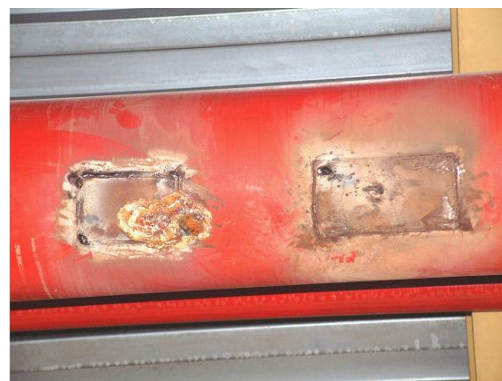
شکل ۸- محل‌های خوردگی لوله آب آتش‌نشانی و جوشکاری آنها
